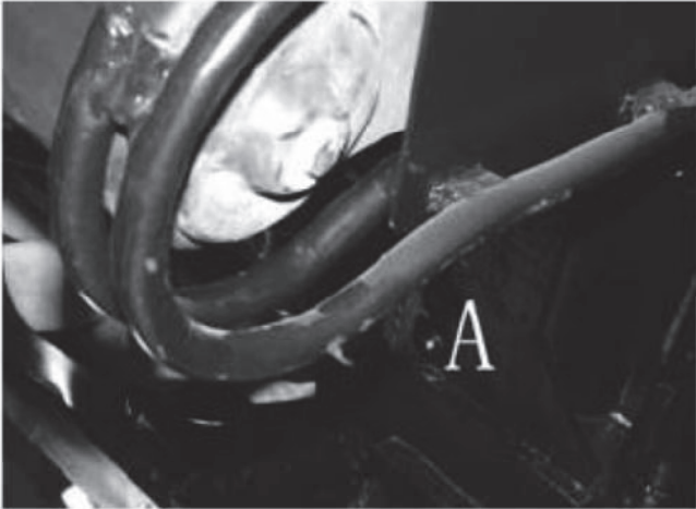
Fig. 5-28 Drenaje de depósitos en el fondo del tanque de combustible
